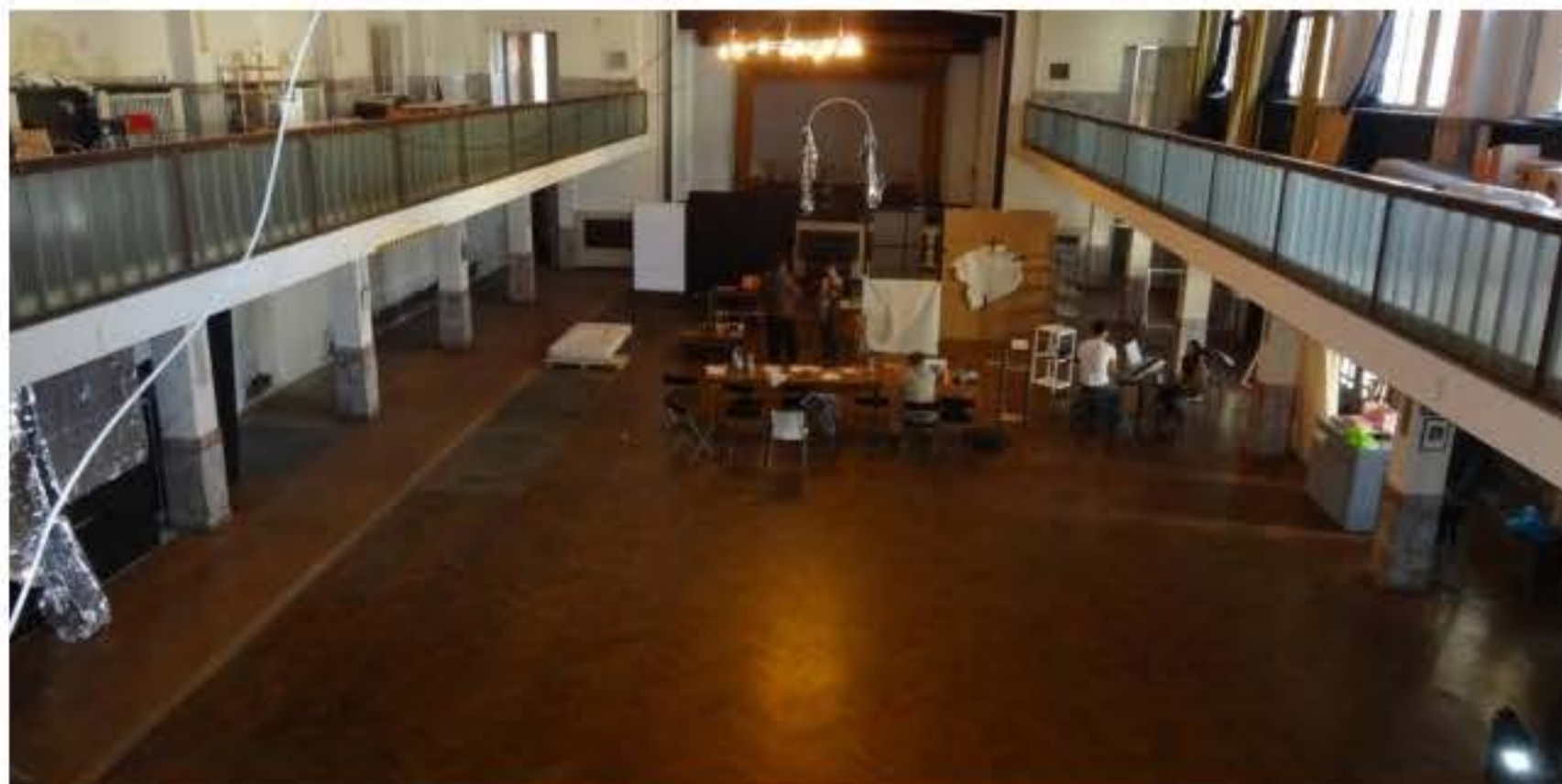
Der historische Ballsaal im Gemeinschaftshaus – ohne Lüftungsanlage und Heizung kann er nicht dauerhaft genutzt werden. Foto: W. Schenk
